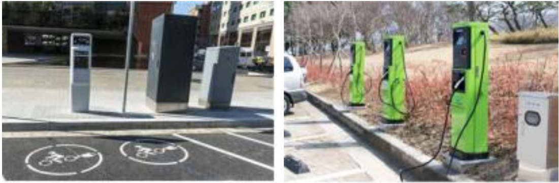
<그림 8-28> 전기 충전시설 예시
